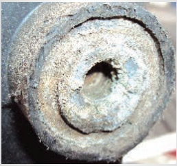
DAÑADA Por golpes o falso contacto en la conexión.
