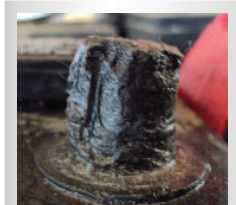
EXCESO DE SUJECIÓN Por terminales demasiado apretadas.
