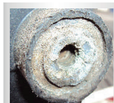
DAÑADA Por golpes o falso contacto en la conexión.
