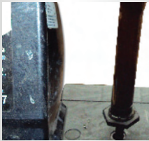
SOBRECARGA Hinchada o inflada por someter la batería a cargas rápidas por falla del regulador.
