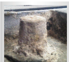
SULFATADO Ocasionado por un golpe.
