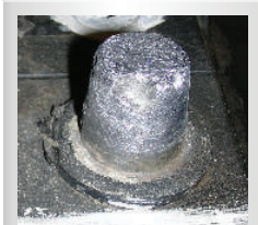
FUNDIDO Ocurre cuando se provoca un corto para comprobar carga.
